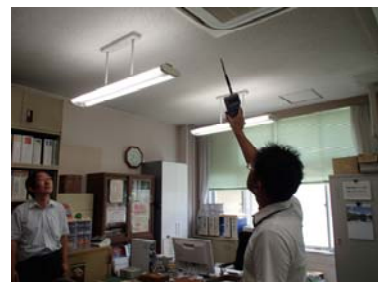
空調機の設定温度と室温の確認
