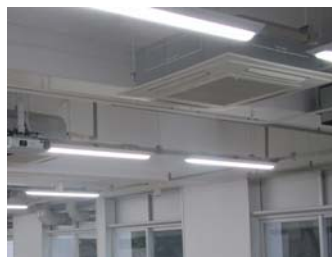
(改修後) LED ライト 62W
