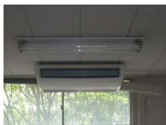
(改修前) 空調用室内機
