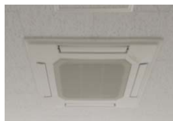
(改修後) 高効率空調用室内
