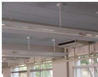
(改修前) 蛍光灯 110W
