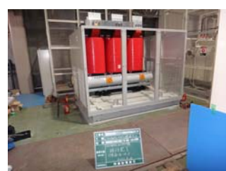
(改修後) トップランナー型変圧器
